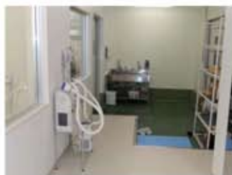
サニタリー室の衛生設備
